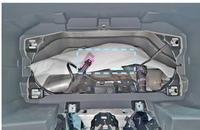
Фото 2.7. Пример расположения центрального блока охранно-телематического комплекса
