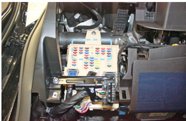
Фото 2.7. Пример расположения центрального блока охранно-телематического комплекса
