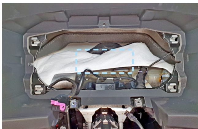
Фото 2.8. Пример расположения центрального блока охранно-телематического комплекса
