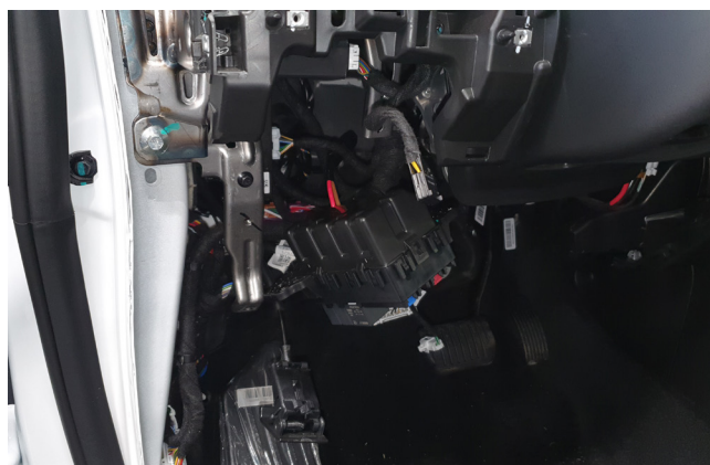
Фото 1.14. Монтажный блок предохранителей снят
