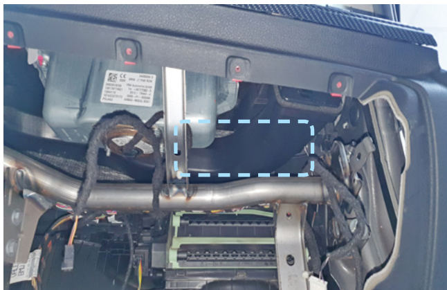
Фото 2.7. Пример расположения центрального блока охранно-телематического комплекса
