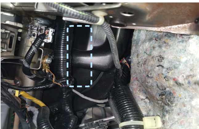
Фото 2.7. Пример расположения центрального блока охранно-телематического комплекса
