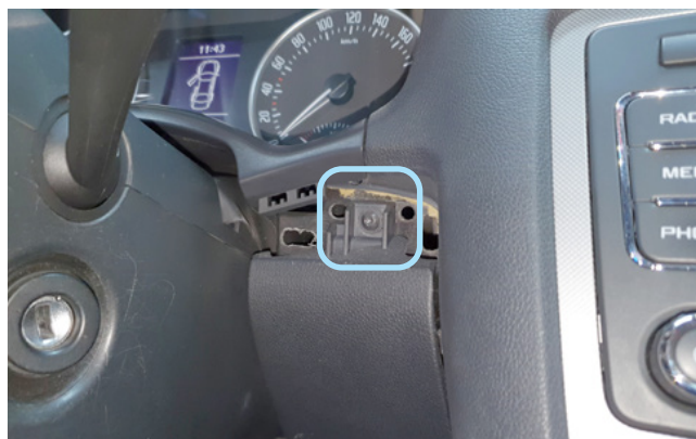
Фото 1.8. Накладка снята. Саморез
