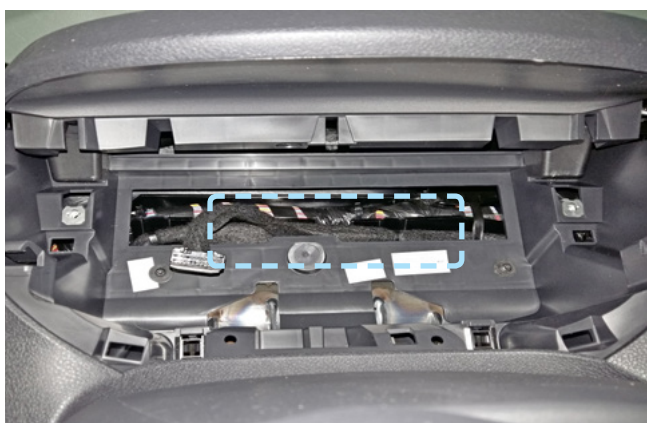
Фото 2.8. Пример расположения центрального блока охранно-телематического комплекса
