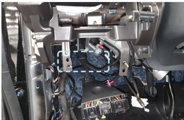
Фото 2.9. Пример расположения центрального блока охранно-телематического комплекса
