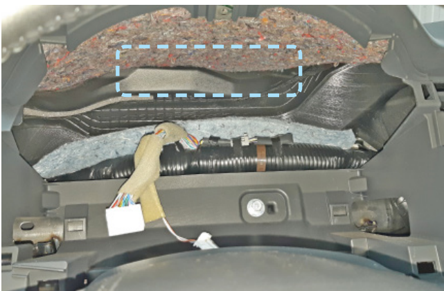
Фото 2.9. Пример расположения центрального блока охранно-телематического комплекса
