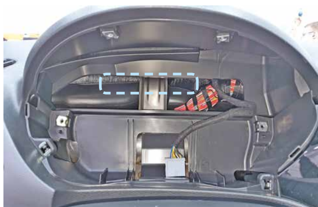
Фото 2.8. Пример расположения центрального блока охранно-телематического комплекса
