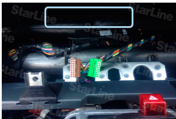
Фото 4. Место установки блока сигнализации
