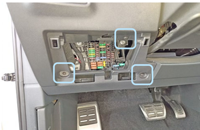
Фото 1.7. Крышка монтажного блока предохранителей снята. Саморезы крепления
