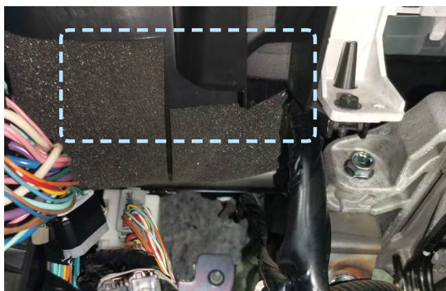
Фото 2.7. Пример расположения центрального блока охранно-телематического комплекса
