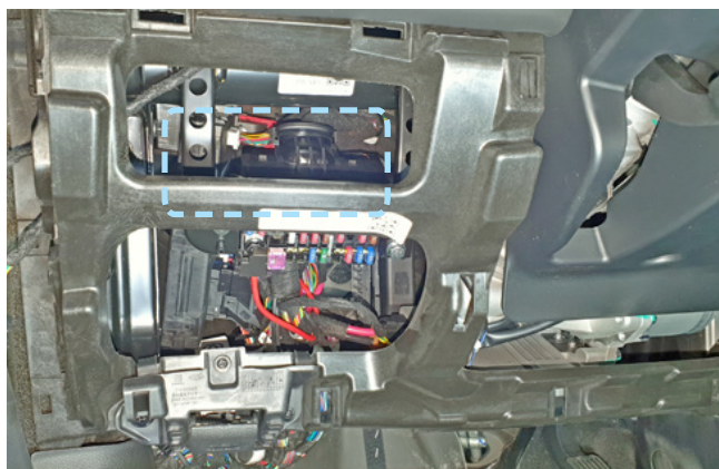
Фото 2.8. Пример расположения центрального блока охранно-телематического комплекса
