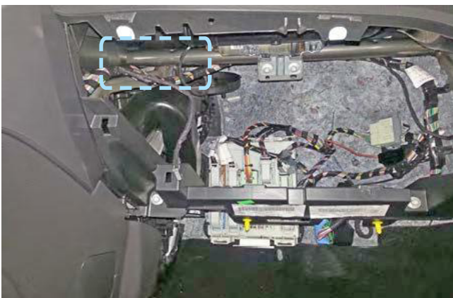
Фото 2.8. Пример расположения центрального блока охранно-телематического комплекса
