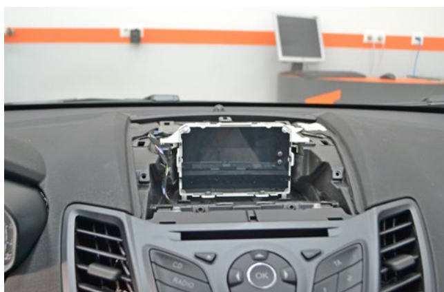
Фото 1.22. Верхняя накладка передней панели снята
